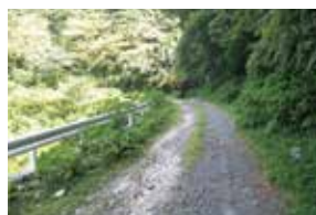
▲口之島の荒れた林道
